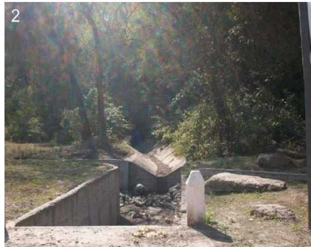
2: Detalle del canal que cruza la calzada, canal que baja de la ladera y canal paralelo a la calzada.
