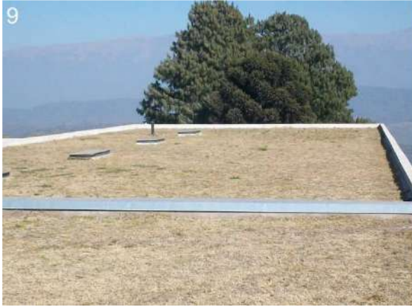
9: Techo de la planta inferior, con “Cubierta Jardín” como característica de esta obra. Respiraderos.
