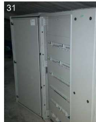
31: Tablero central de electricidad del pabellón nuevo de Arquitectura.
