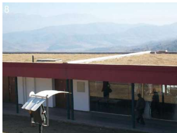
8: Vista superior del techo de las habitaciones y del comedor. Luces reflectoras, ubicadas en todo el patio.
