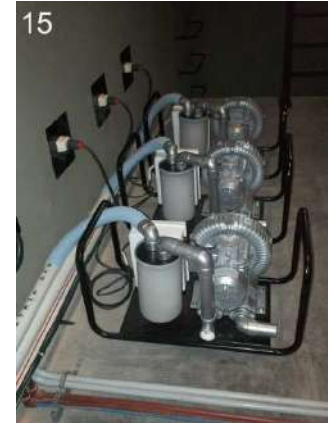
15: Compresores y filtros de aire para los boxes odontológicos.
