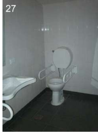
27: Detalle del sector del inodoro con barrales móviles de los dos lados.
