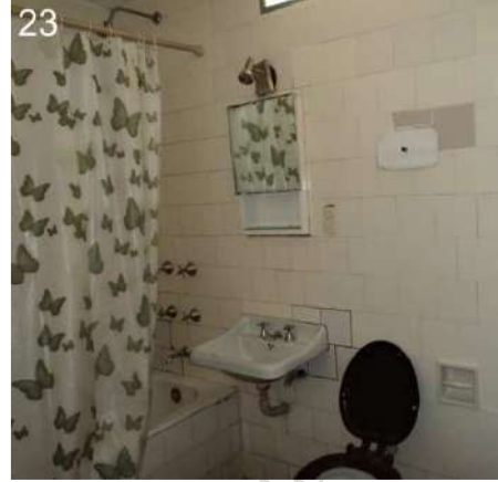
23: Baño con las instalaciones anteriores.
